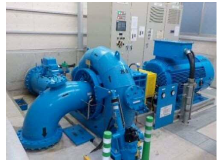
県営事業施設：小水力発電機
