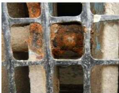
スクリーンパー発錆状況 (安濃ダム)
