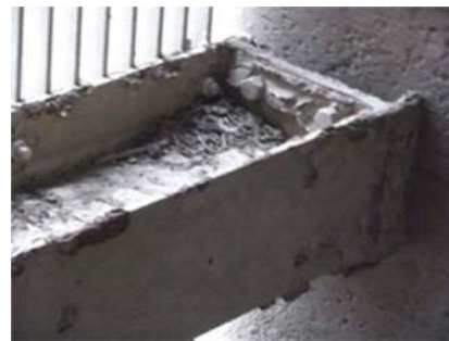
スクリーン受桁発錆状況 (安濃ダム)
