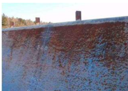
扉体塗装劣化・発錆状況 (第三頭首工)
