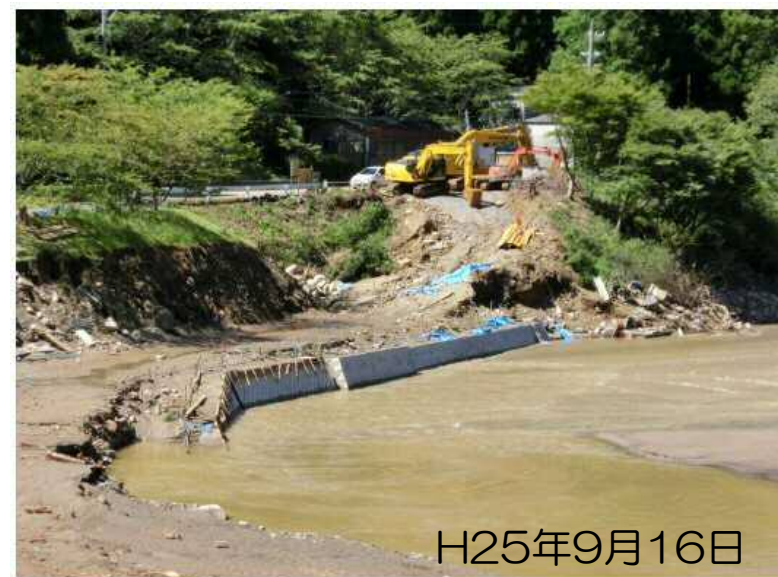
台風19号後の被災状況
