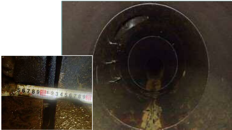
用水路の劣化（目地開き）
