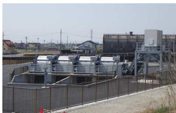
1号サイホン除塵機
