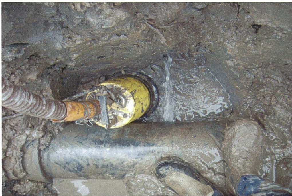
石綿セメント管の破損状況（例）
