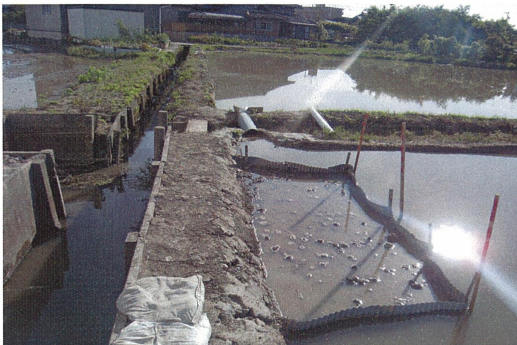
石綿セメント管の破損による農地のたん水
