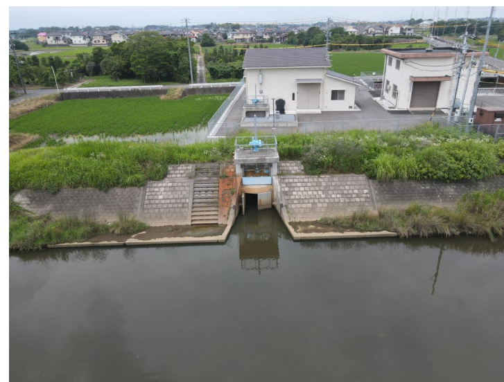
牧川第二排水機場(新設)
