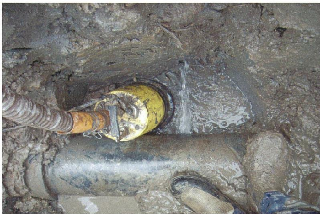
石綿セメント管の破損状況（例）
