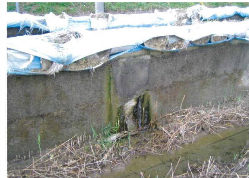
用水路の破損
