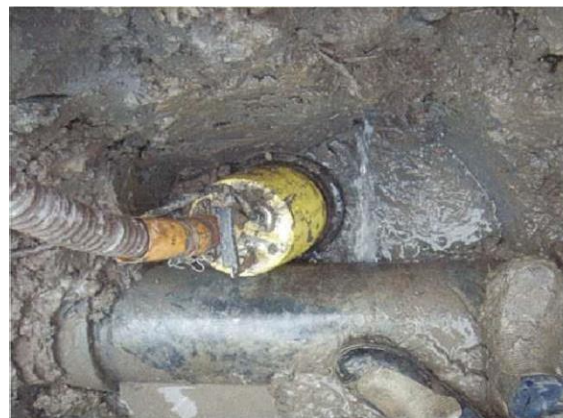
【末端水路の漏水】
