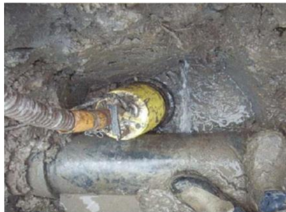
【末端水路の漏水】
