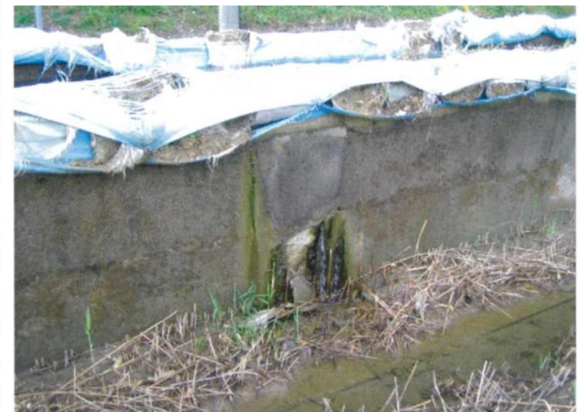
用水路の破損
