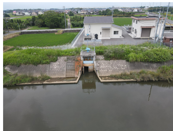
牧川第二排水機場(新設)
