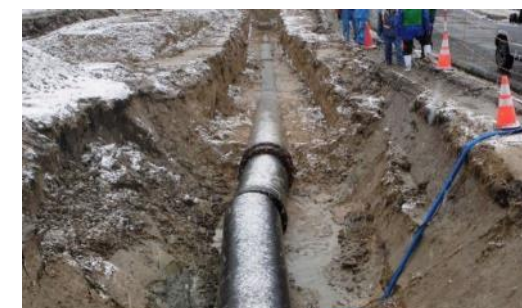
地震による継手の破損
