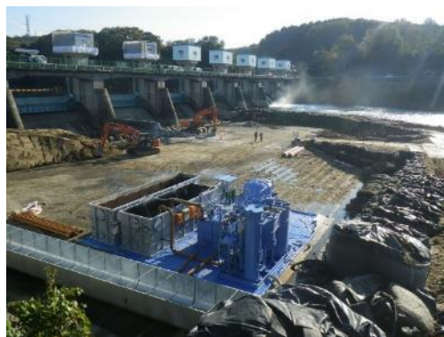
河川内工事の汚濁水処理設備
