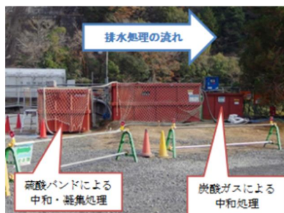
排水処理設備
