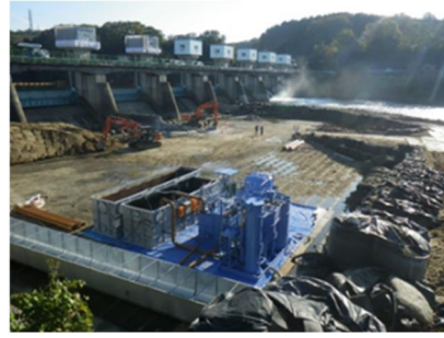
右岸仮締切内の汚濁水処理設備
