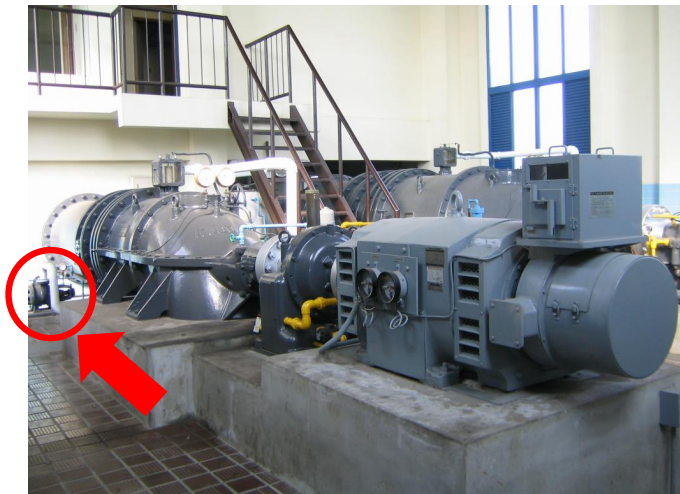
横軸タイプの補機類の故障が多かった。
