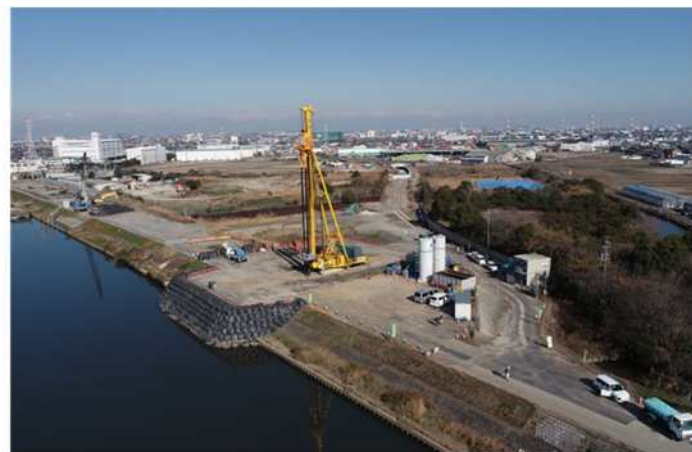
十三沖永排水機場
