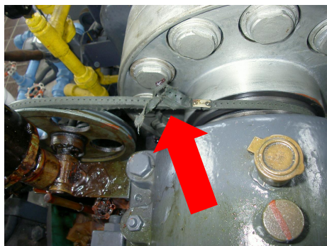
グリスロープ破損
