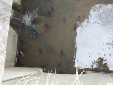
落水後の集水樹の状況
