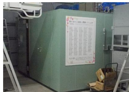
クラウドファンディングにより整備した穀物保冷库（みんなの蔵）
