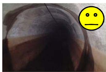
トンネルにひび割れ
