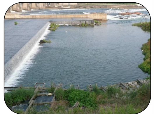
河床の低下した犬山頭首工
