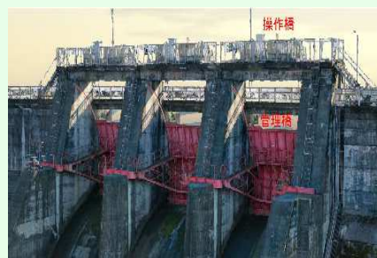
羽布ダム洪水吐ゲート
