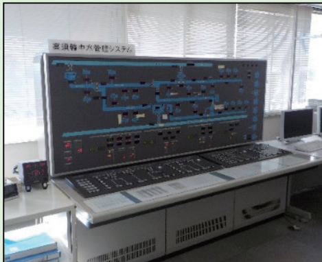
監視操作卓(既設)
