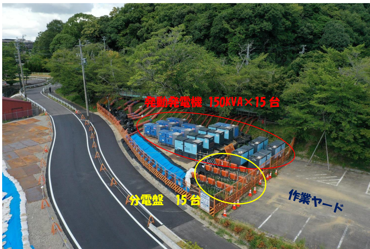
発動発電機（150KVA×15 台）設置イメージ
