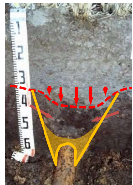
疎水材（モミガラ）の腐食等により耕盤が沈下し、両側から土が流入 〔疎水材（モミガラ）の腐食状況〕
