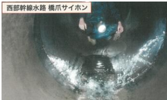
継ぎ目から地下水が流入している状況
