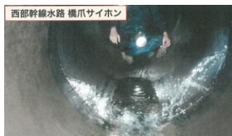
継ぎ目から地下水が流入している状況
