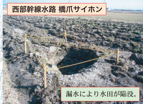
西部幹線水路 橋爪サイホン
