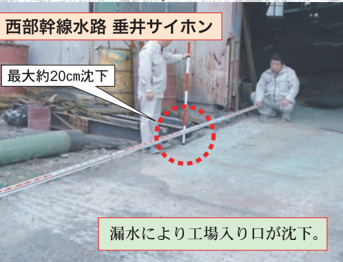
西部幹線水路 垂井サイホン
