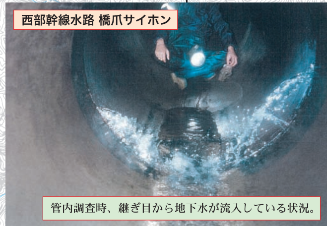
西部幹線水路 橋爪サイホン
