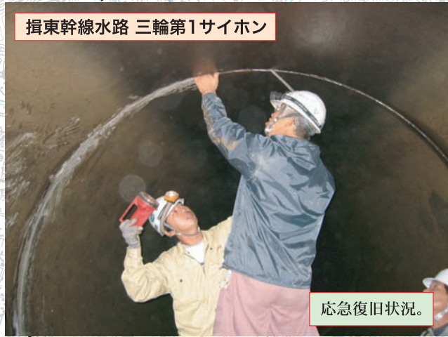
揖東幹線水路 三輪第1サイホン
