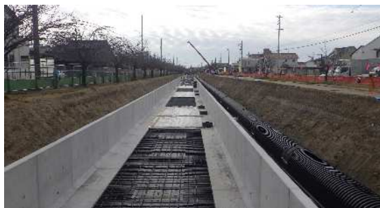
L形製品の間に鉄筋を組み、コンクリートを打設しています。
