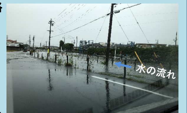
同日の未改修区間の状況
