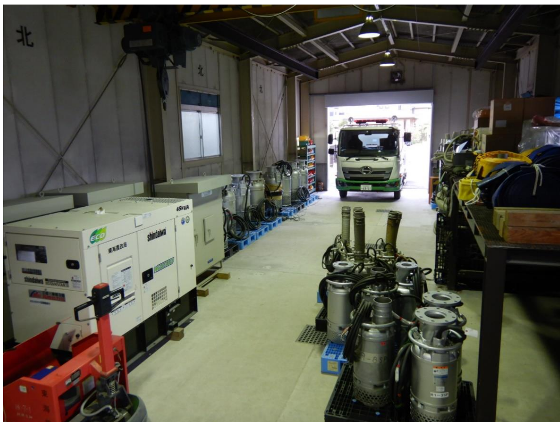
災害応急用ポンプ等保有状況
