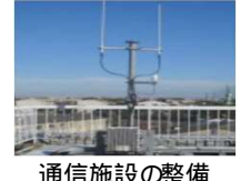
通信施設の整備
