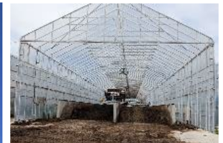
堆肥乾燥ハウス
