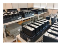
バッテリーの 保管・充電施設
