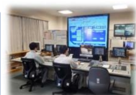
施設管理（監視、操作）の状況
