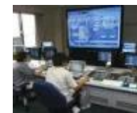
管理状況(操作室)
