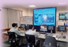
施設管理（監視、操作）の状況
