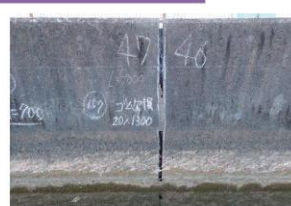
▲目地の劣化状況
