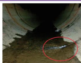
▲管内の漏水状況
