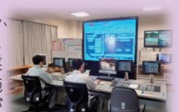
施設管理（監視、操作）の状況
