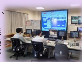
施設管理（監視・操作）の状況
