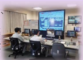
施設管理（監視・操作）の状況
